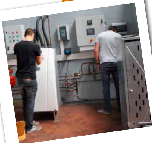
Pompe à chaleur
